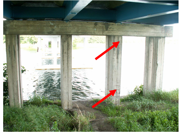
Rys. 4. Korozja zbrojenia z odsypinami i zarysowaniami otuliny w słupach filara F1
