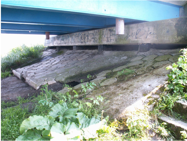
Rys. 15. Uszkodzone schody i ścieki skarpowe przy przyczółku początkowym
