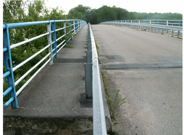
Rys. 10. Uskok za dylatacją końcową przy zjeździe z mostu, zarośnięte krawężniki
