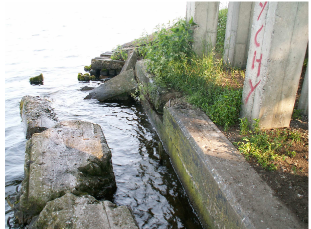
Rys. 18. Gruzowisko żelbetowe przy skarpie przyczółka początkowego
