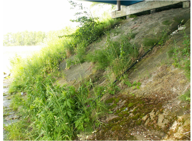
Rys. 16. Uszkodzony stożek skarpy przy przyczółku końcowym
